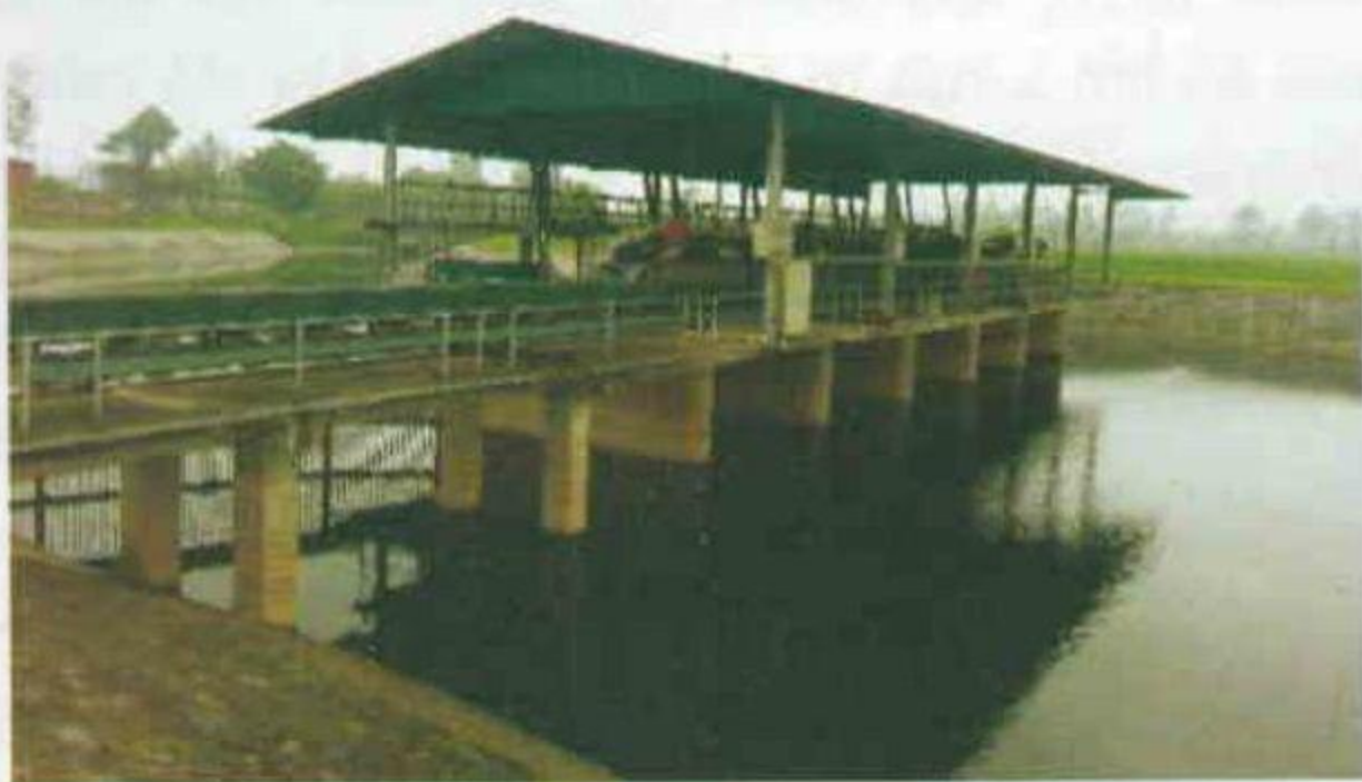
Hình 7. Thiết bị vớt rác trạm tại trạm bơm Vạn An - tỉnh Bắc Ninh
